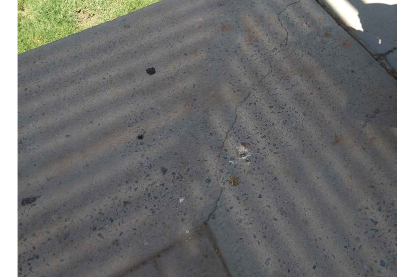
LR1.-FISURA EN FIRME
