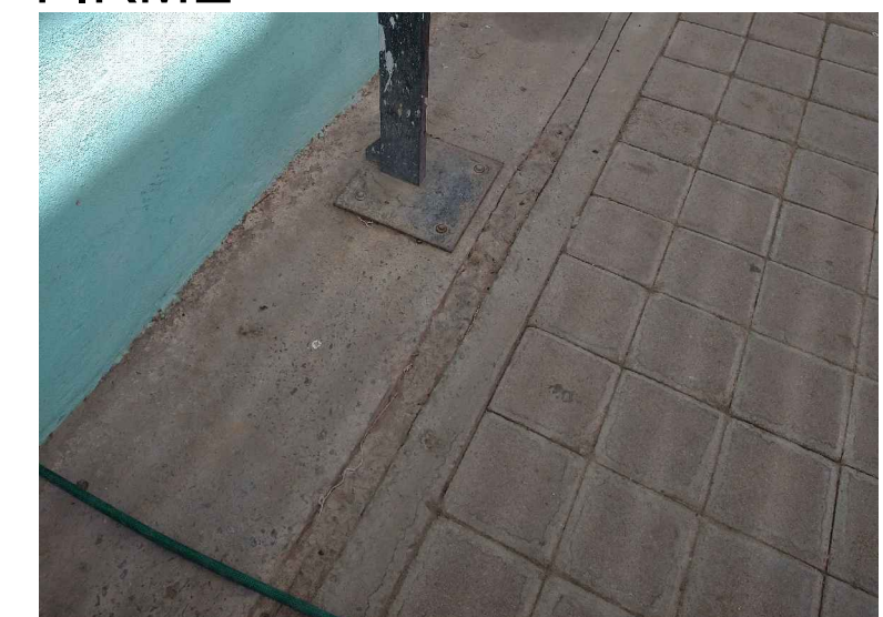
LR4-5.- FISURA EN FIRME
