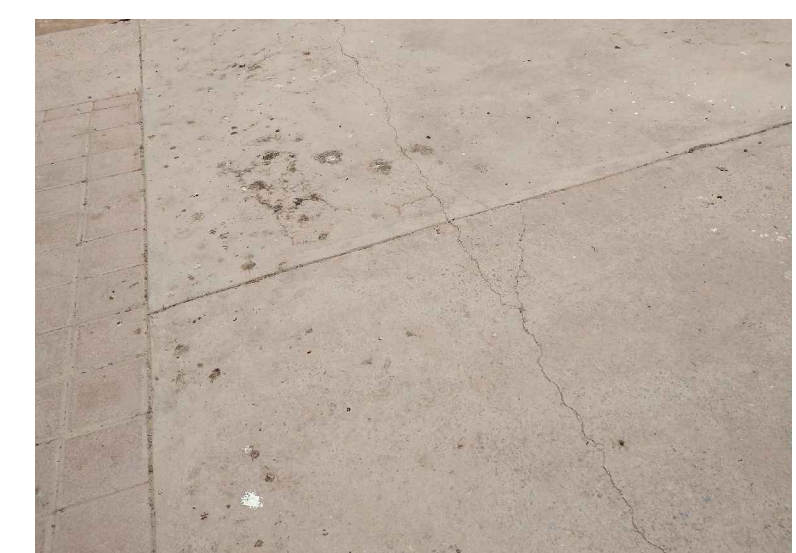
LR3.- FISURA EN FIRME
